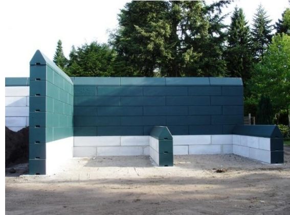
Area stoccaggio - parete protezione antincendio, foto: MEGABLOC
